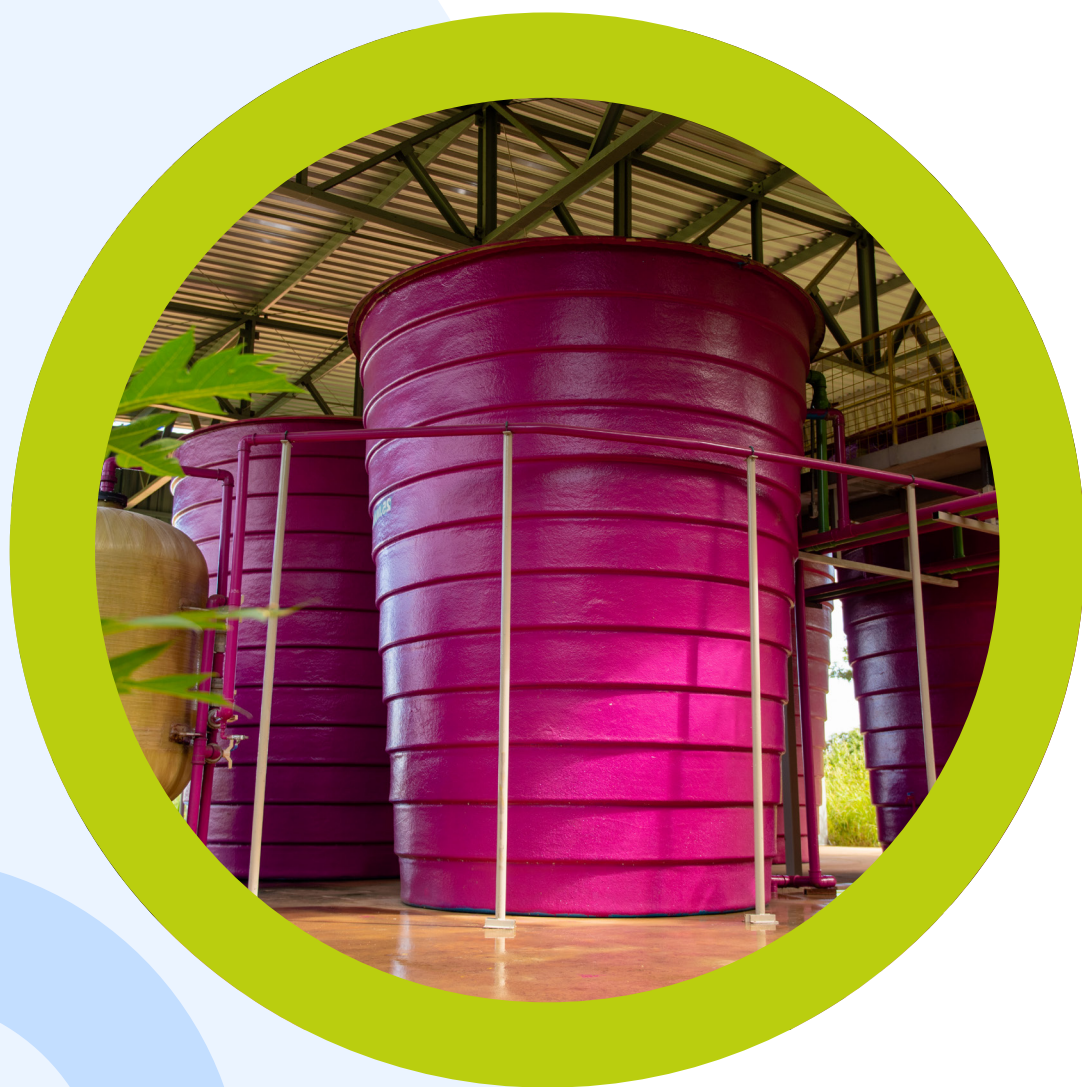
Estación de Tratamiento de Efluentes - Unidad Crato (CE)
